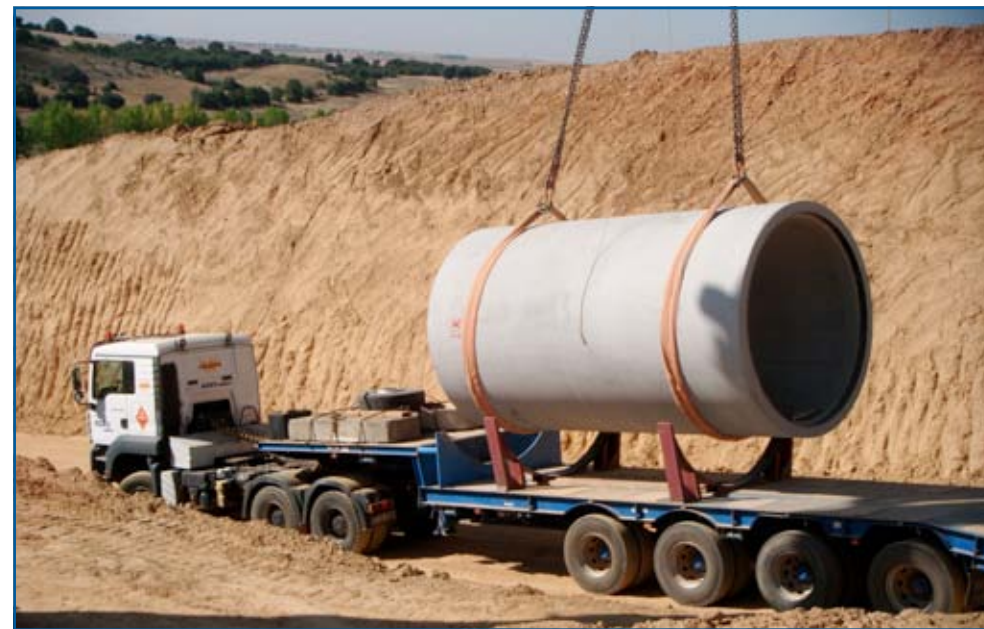
Tubería para conducción hídrica
