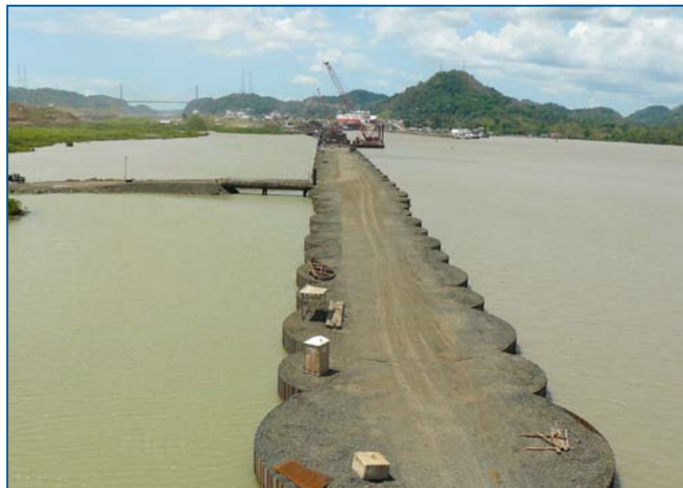
Construcción del acceso del cauce del Pacífico en el Canal de Panamá
