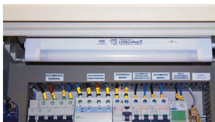
Punto de luz para mantenimiento
