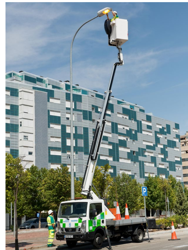
Mantenimiento Alumbrado de Madrid.
