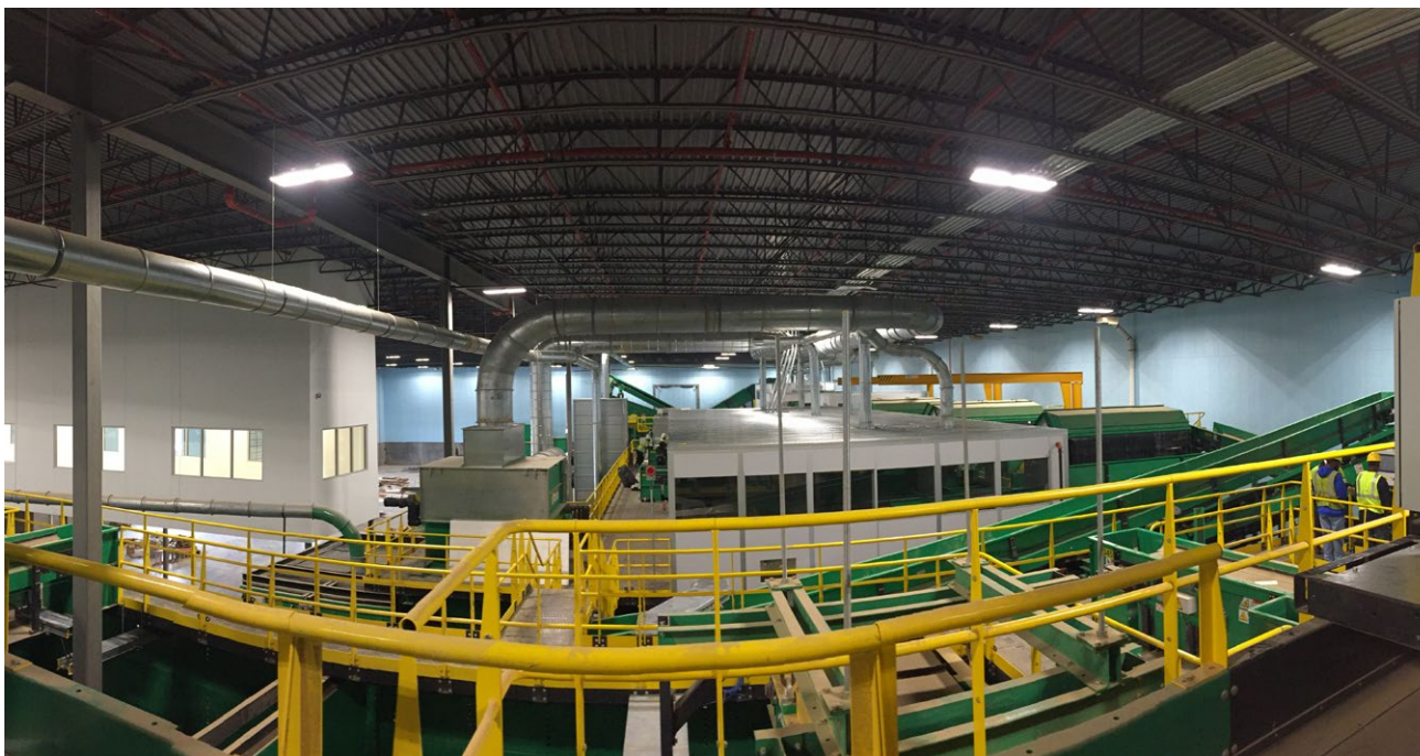
Planta de reciclaje de Dallas (Tejas, EE.UU.).
