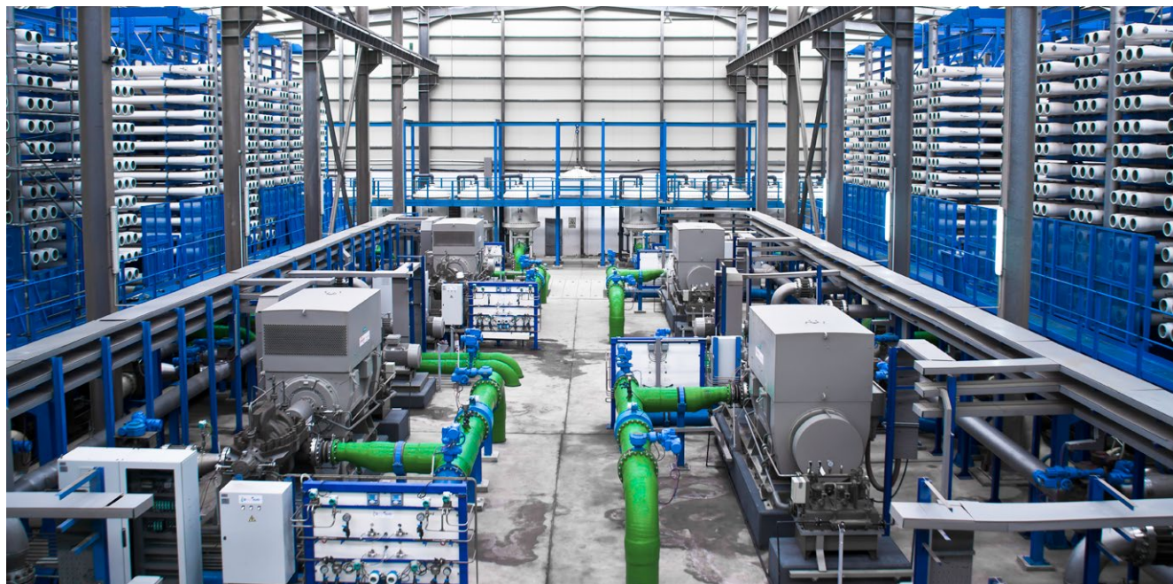
Desaladora de Mostaganem (Argelia).
